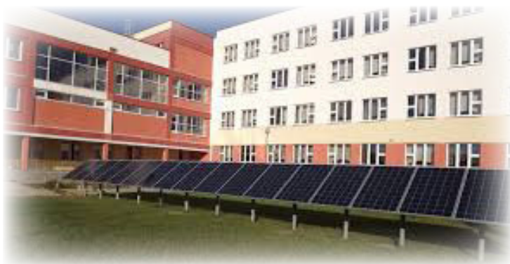
Fig. 17. Panouri solare fotovoltaice în curtea instituției de învățământ
